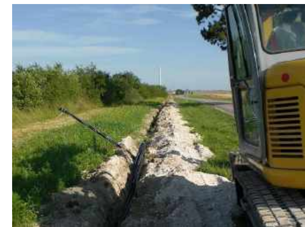
Photo 31 : Pose de câbles électriques et réalisation de tranchée à la pelle mécanique (Source : BE Jacquel et Chatillon)
