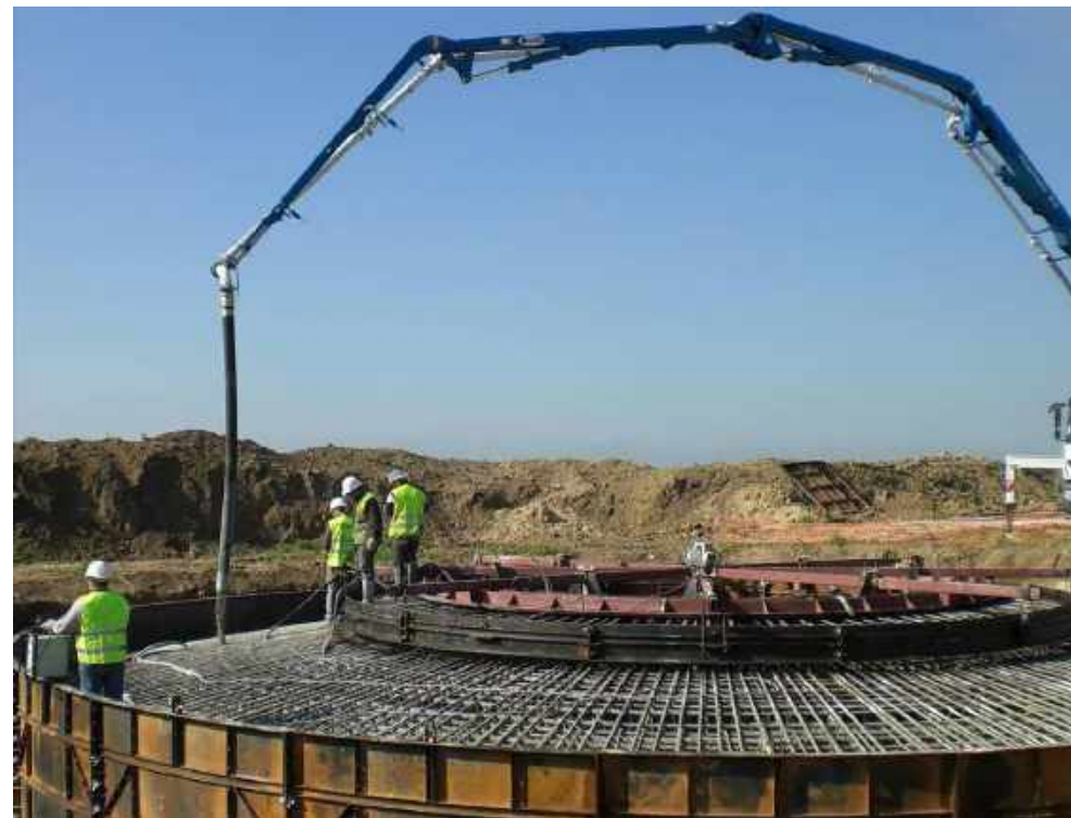
Photo 30 : Exemple de coulage du béton de fondation d'éolienne (Source : BE Jacquiel et Chatillon)
